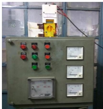
Fig. 2.7 (a) Image of Actual Control Panel.
